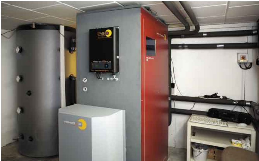
Energiezentrale: Wärmepumpe, Pufferspeicher, Wechselrichter und die Steuerung der gesamten Technik wurden im Keller in einem Block zusammengefasst. Das erhöht den Montage- und Betriebskomfort, spart darüber hinaus auch noch Platz.
