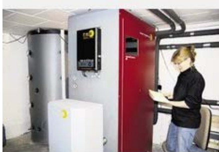
In der Heizzentrale mit Steuerung, Pufferspeichehr und Pumpen kann Christine Schön aktuelle Daten ablesen.
